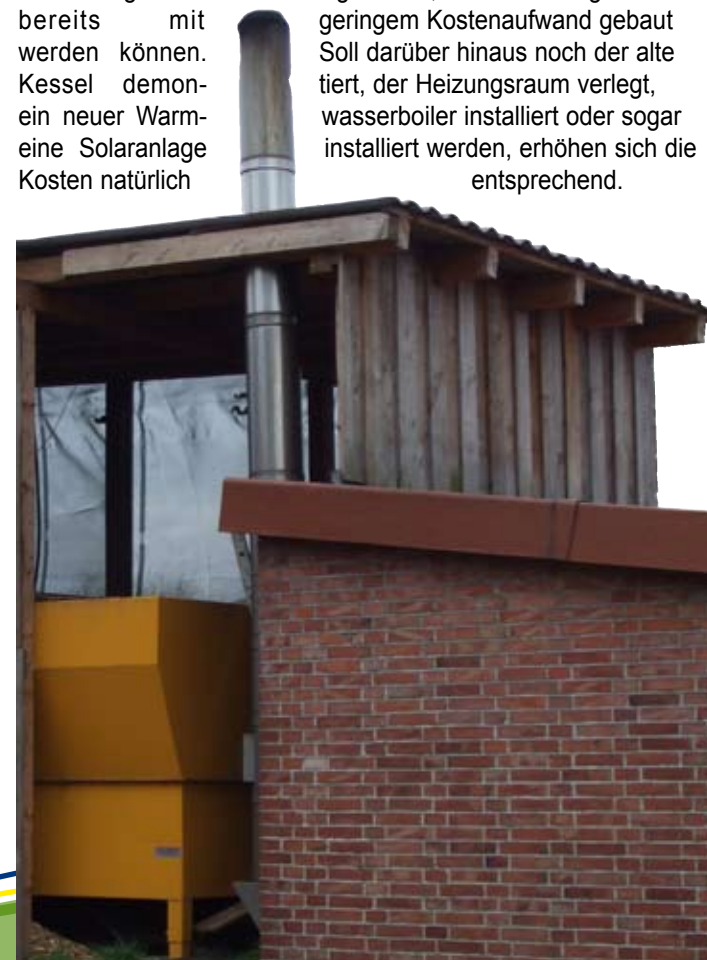
So sieht eine Holzhackschnitzelheizung aus, die Wärmeenergie in ein Nahwärmenetzwerk einspeist.
